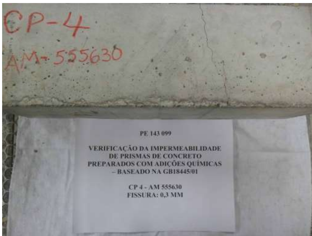
CP 4 Muestra 555630 – Fisura 0,3 mm
